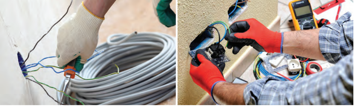
Görsel 7.2 Elektrik düğmelerine ve prize elektrik duvardan geçen kablolar yardımıyla gelir.
